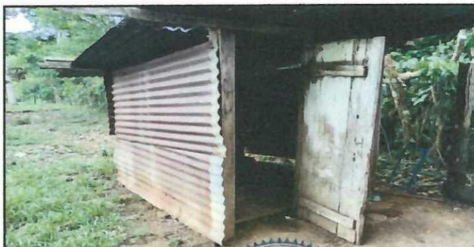
Foto 5: CAMBIO DE ESTRUCTURA DE SANITARIOS Y PUERTAS. Se mejorarán las paredes de los sanitarios debido a que se encuentran en mal estado.
