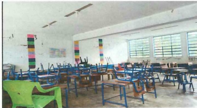
Foto 2: PINTURA INTERIOR DE AULAS. Se pintarán los muros interiores y exteriores de las aulas debido a que se encuentran en malas condiciones.
