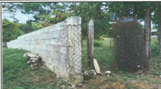
Foto 1: CONTINUIDAD DE MURO PERIMETRAL. Se hará el mejoramiento para culminar el muro perimetral, debido a que los niños salen del perímetro del establecimiento en horario de receso.
